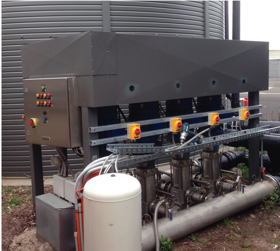
KATKO EMC turvakytkimiä asennettuna vedenpuhdistusjärjestelmään Sydneyn kansainvälisellä lentokentällä.
